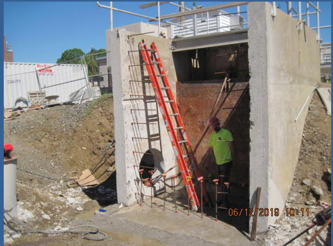
Effluent Distribution Box
