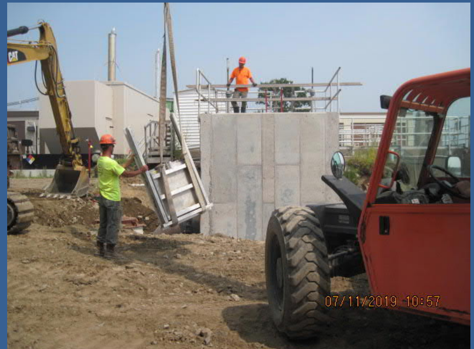
Effluent Distribution Box
